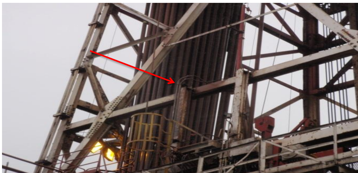
Figur 8-2: Lekkasje fra IRA (Intermediate Racking Arm) Rød pil viser punkt for lekkasje.
