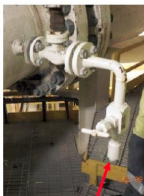
Tilkoblingspunkt for nitrogenslangen
