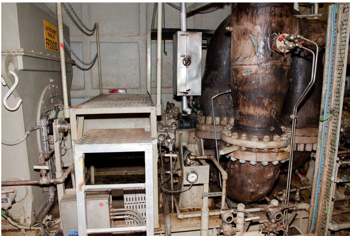
Bilde 4 - Skader etter brann ved driv-enden til lastepumpe D
