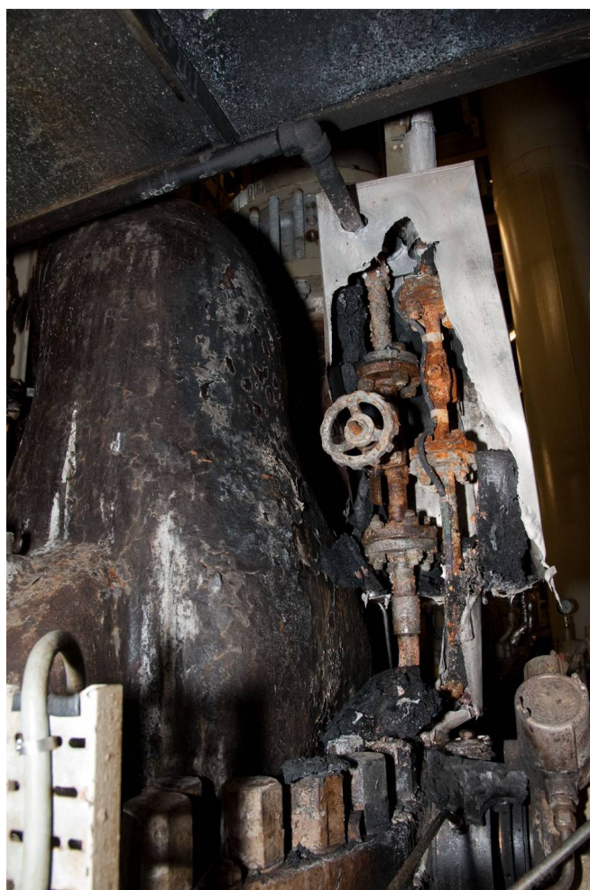
Bilde 6 - Smeltet isolasjonskasse ved driv-enden til lastepumpe D
