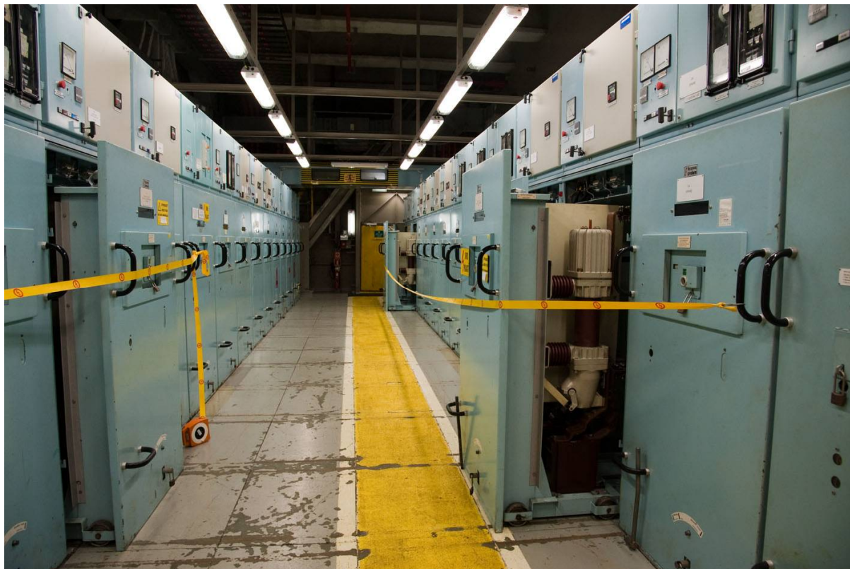
Bilde 1 - Bryterskuffer i tavlerom KC0001
