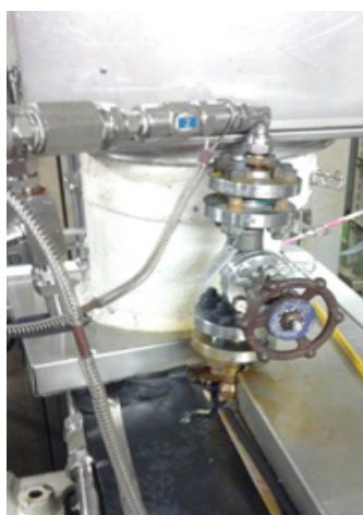
Figur 2 - Kondensatpumpe påmontert rørstuss. Bilde tilhører Engie E&P
