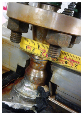
Figur 3- Sprekk i rørstuss som førte til kondensatlekkasje. Bilde tilhører Engie E&P
