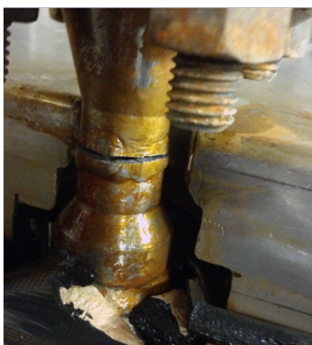
Figur 11 - Brudd i sveis på 1/2"rørstuss. Duplex stål. Bilde tilhører Engie E&P.
