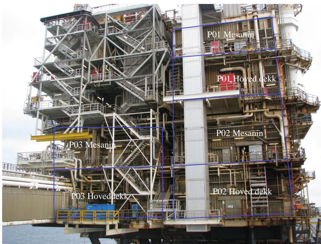
Figur 2: Ula produksjonsplattform. Modulenes plassering er tegnet inn på bildet.
