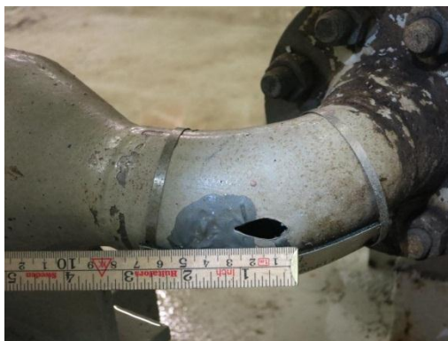
Figur 6 Hull erodert i bend, foto: Statoil
