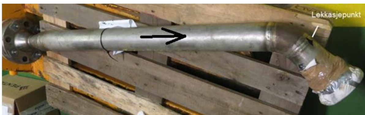
Figur: Trykkavlastningsrør med lekkasje. Pilen angir strømningsretning.
